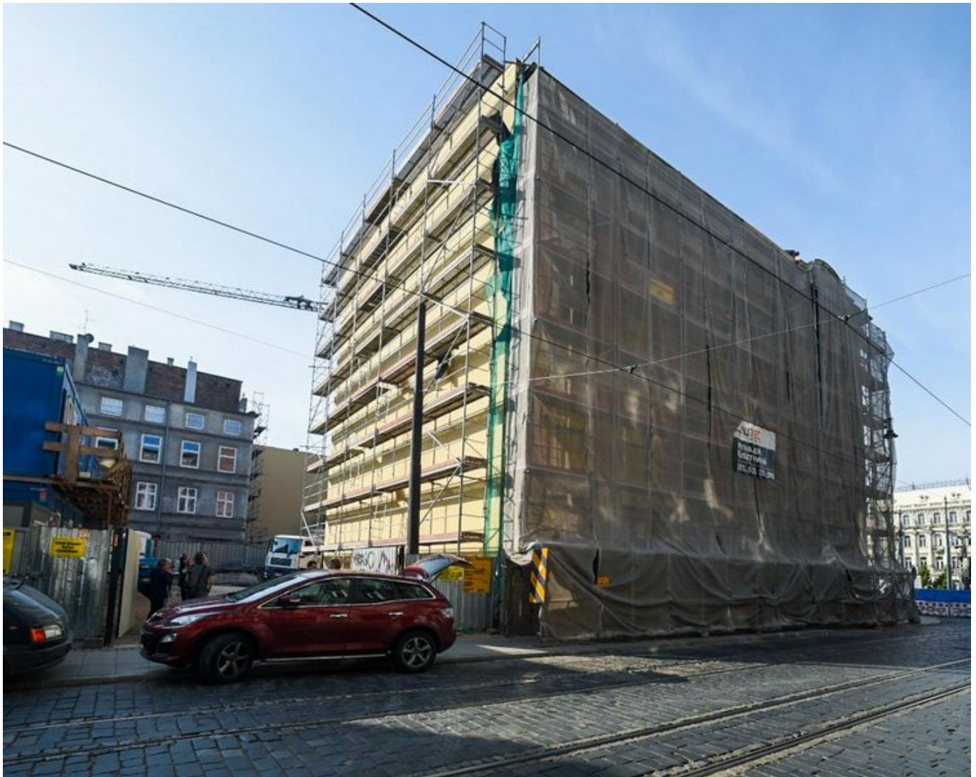
W kamienicy przy ul. Zielonej 6 trwają prace budowlane , fot. Paweł Łacheta / UMŁ
