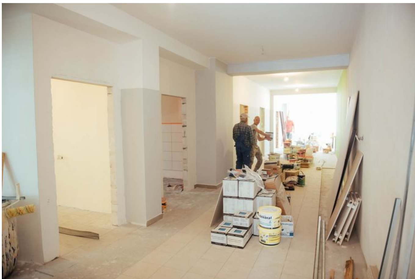
W przychodni przy ul. Murarskiej 4 trwa adaptacja pomieszczeń na parterze , fot. Radosław Żydowicz / UMŁ
