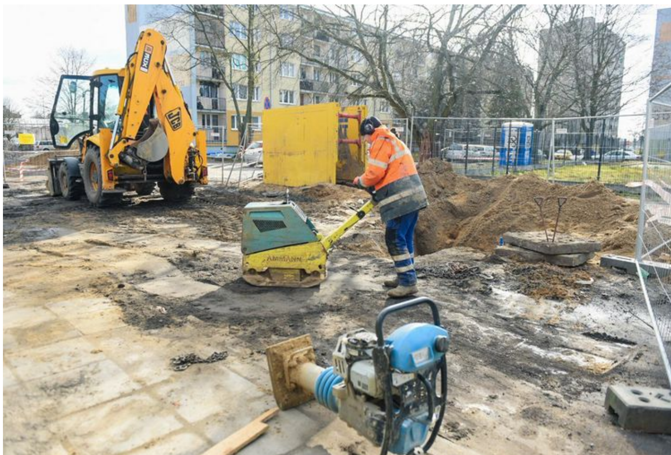
Trwa przebudowa ul. Wróblewskiego od ul. Bratysławskiej do al. Bandurskiego. , fot. Paweł Łacheta
