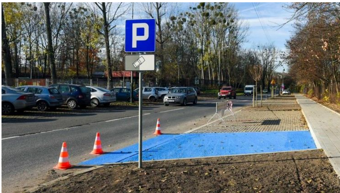
Przy ulicy Źródłowej między ulicami Smugową a Sporną powstały miejsca parkingowe oraz wybudowano chodniki , fot. UMŁ
