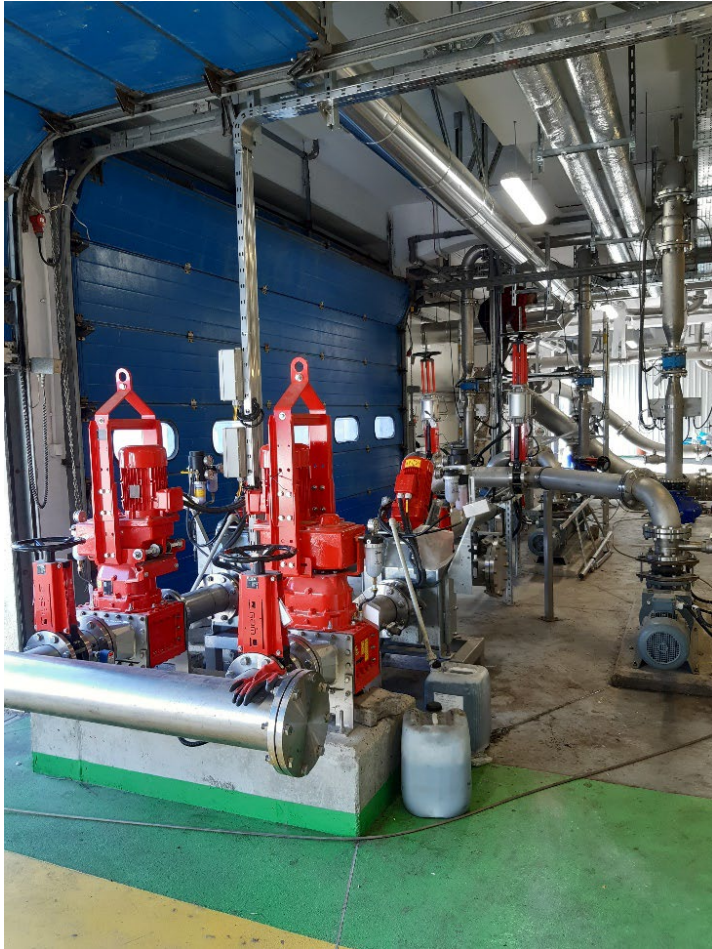
Instalacja osadu po I stopniu fermentacji (rozdrabniacze, maceratory, pompy nadawy na wirówki).
