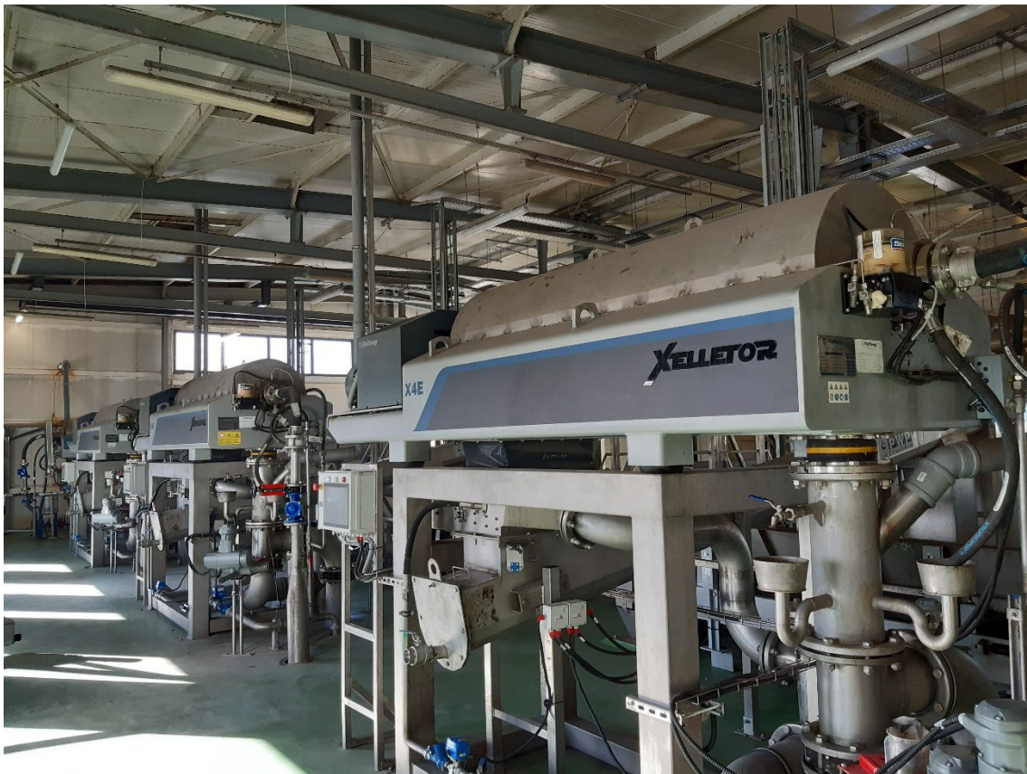
Wirówki dekantacyjne W2, W3, W4.
