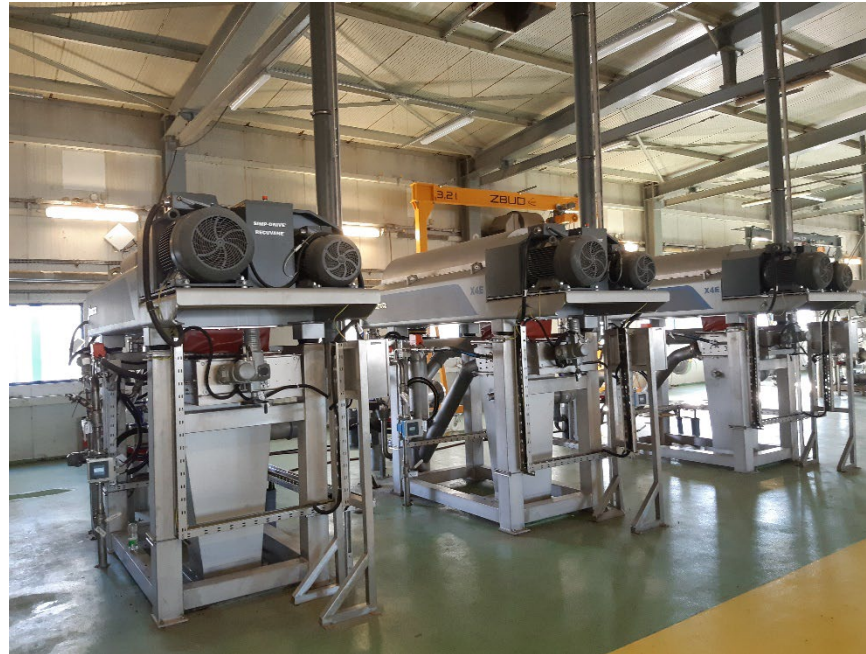
Wirówki dekantacyjne – odwadnianie osadu przed hydrolizą.
