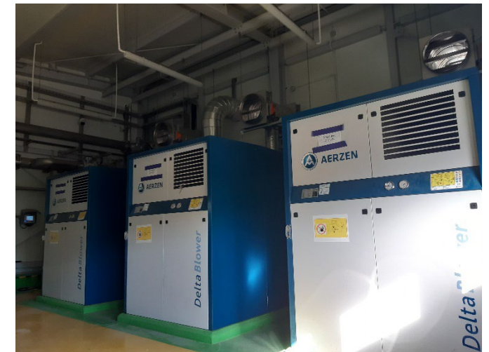
Dmuchawy w budynku technicznym.
