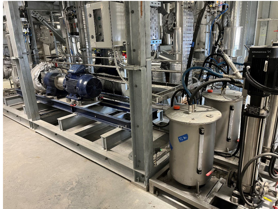
Instalacja hydrolizy – mieszacz dynamiczny.
