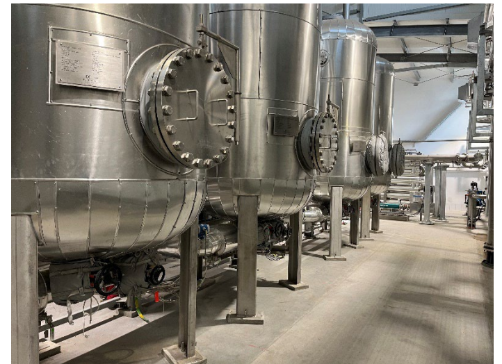
Instalacja hydrolizy – zbiorniki procesowe.
