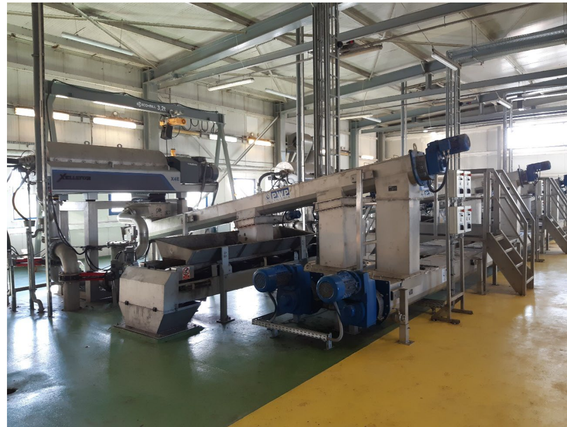
System transportu osadu z wirówek do ITPO lub kontenerów.
