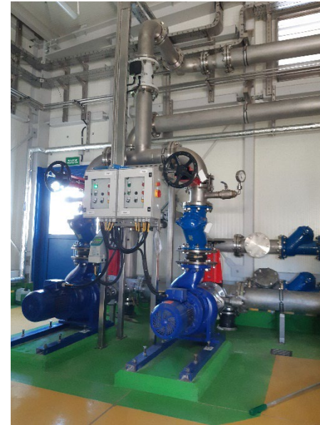
Pompy cyrkulacyjne osadu w budynku technicznym.
