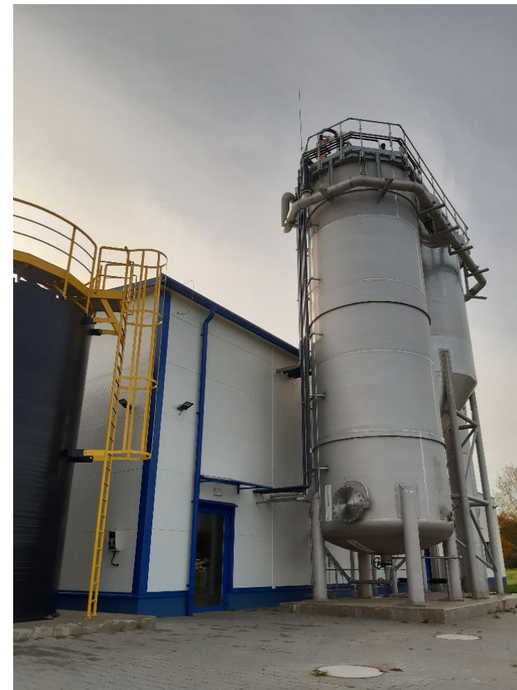
Instalacja odzysku fosforu – część zewnętrzna.
