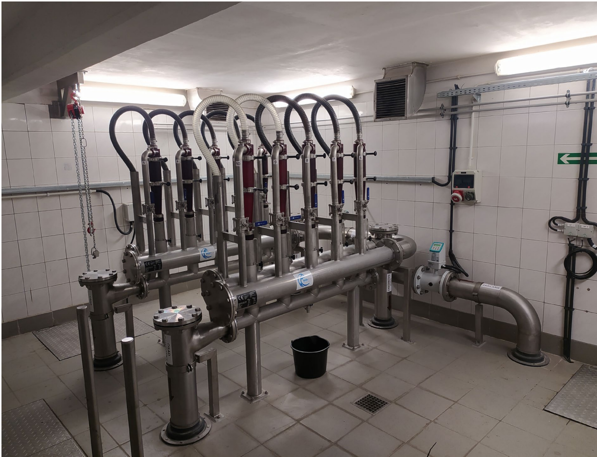
Hydrocyklony inDense zlokalizowane w pompowni osadu czynnego 4.4.
