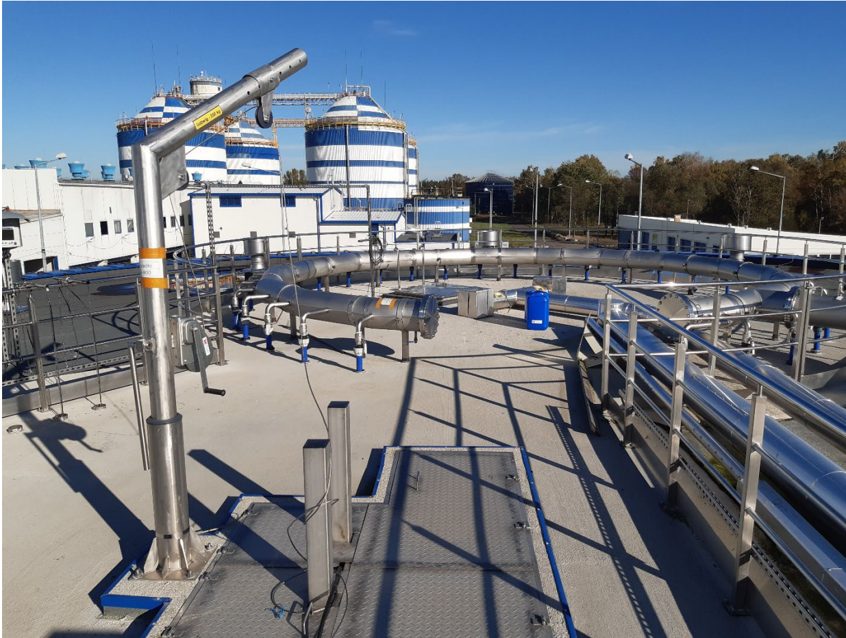
Korona zbiornika deamonifikacji wraz z rurociągami technologicznymi.
