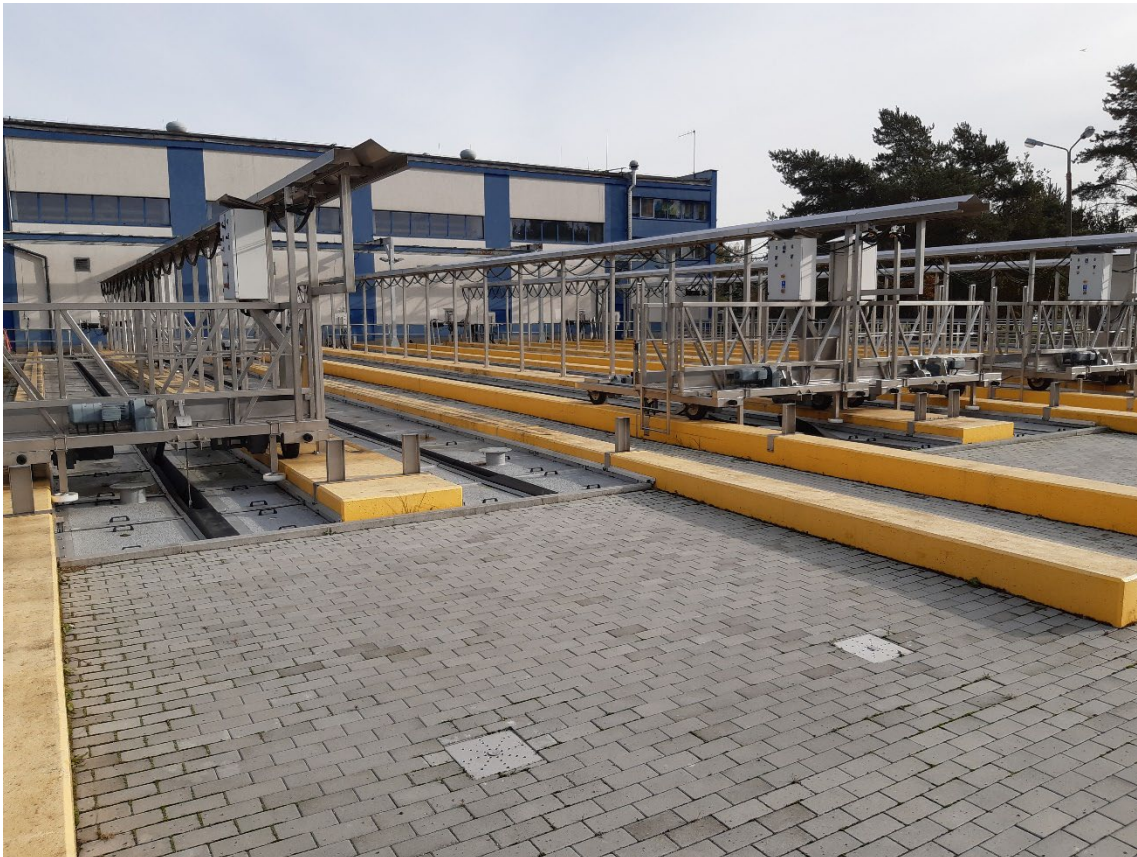
Widok na piaskowniki od strony odpływu.
