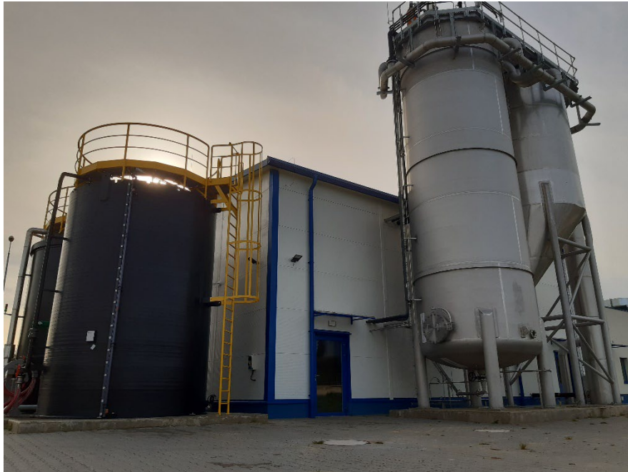
Zbiorniki NaOH i MgCl 2 , hala technologiczna, reaktor z osadnikiem.
