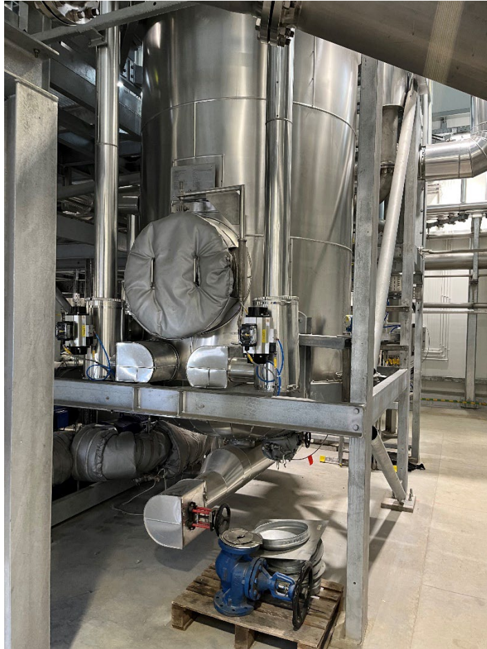
Instalacja hydrolizy – zbiornik przygotowania osadu.
