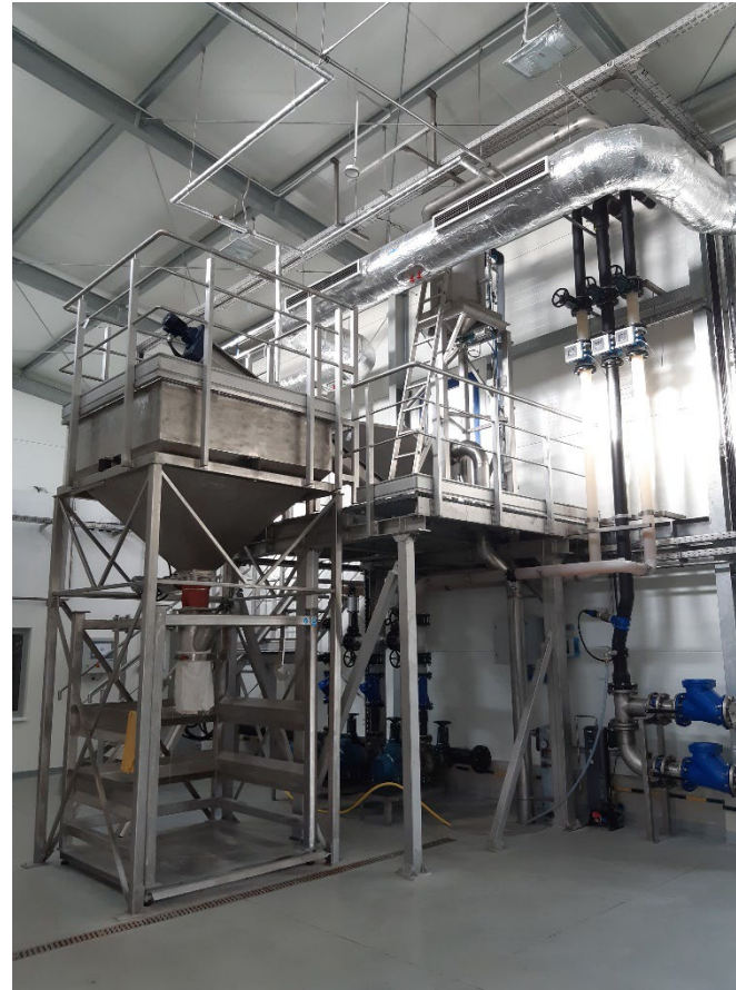
Instalacje technologiczne z systemem odbioru struwitu.
