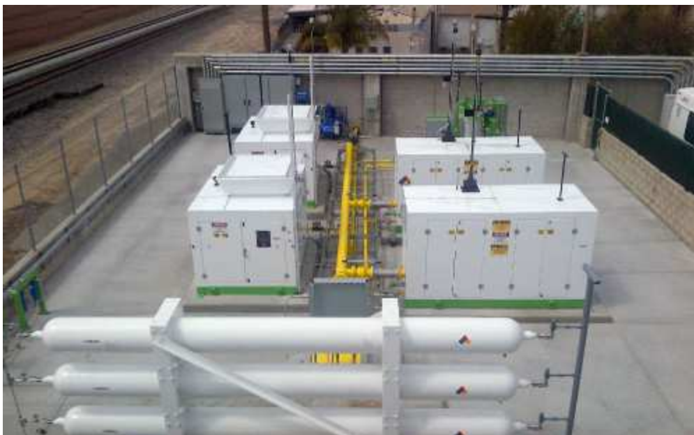
Rysunek 19 Kompresory oraz magazyny buforowe stacji CNG, źródło: http://cngcenter.com/services/cng-station-installation/cngfillstation/
