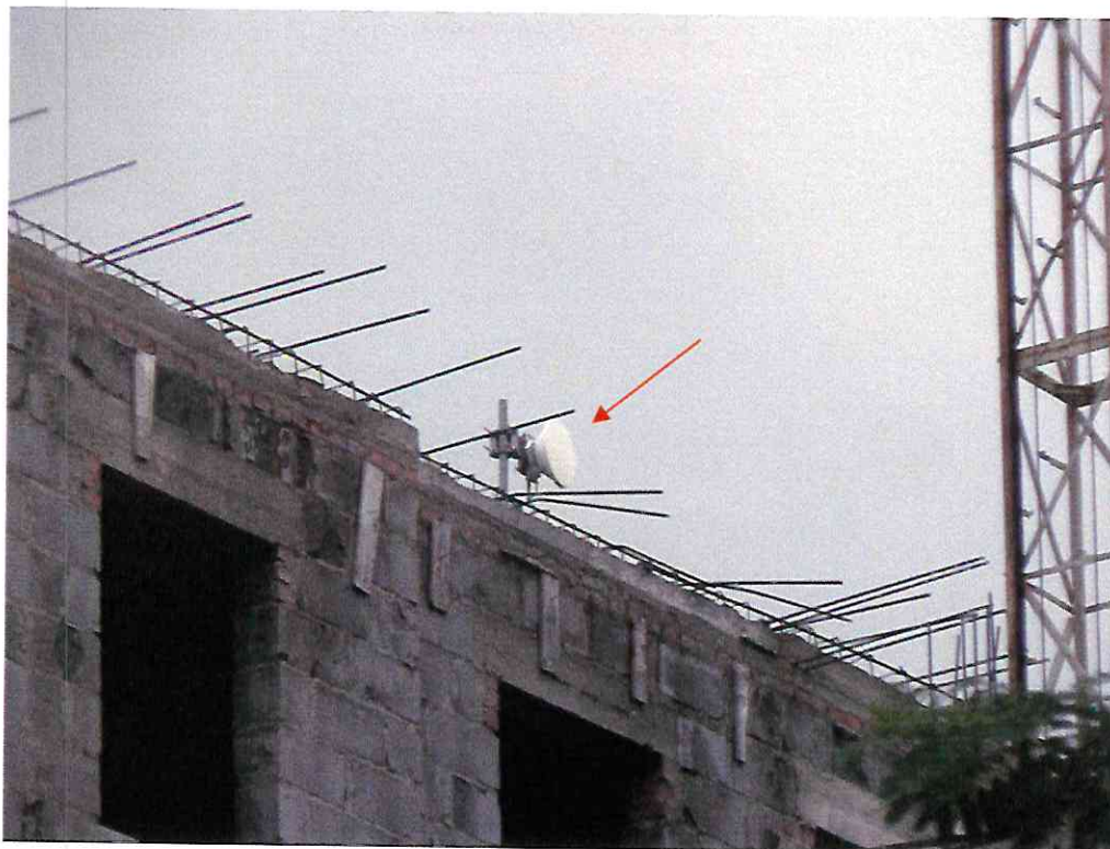
Widok instalacji radiokomunikacyjnej Stacja Netia LODZD606 - LODZM00474 Łódź, ul. Ogrodowa 16.
