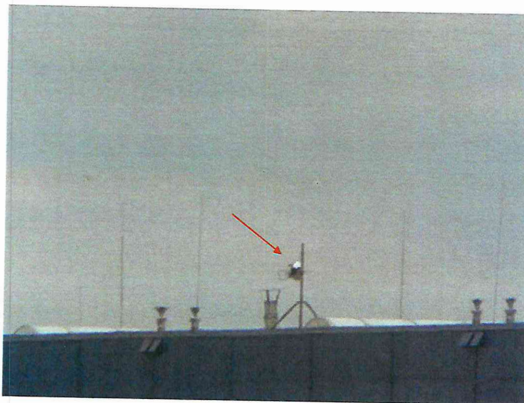
Widok instalacji radiokomunikacyjnej Stacja Netia LODZD576 - LODZM00469 Łódź, ul. Jędrzejowska 79.
